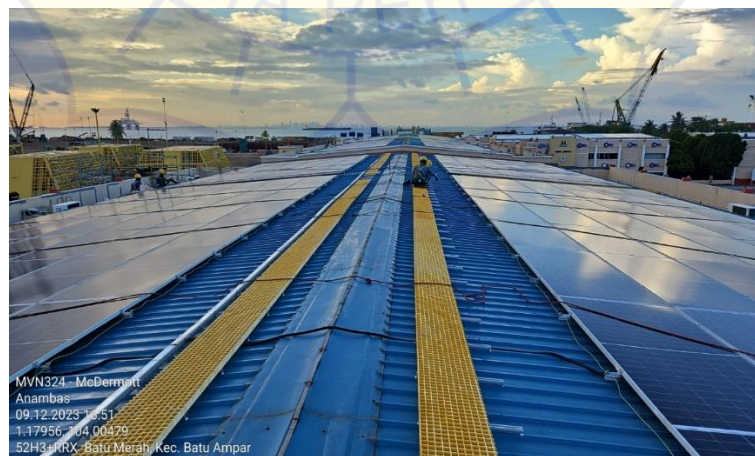
Gambar Metode pemasangan Rooftop Racking di salah satu PLTS Atap 6,2 MWp Pelanggan di Batam
