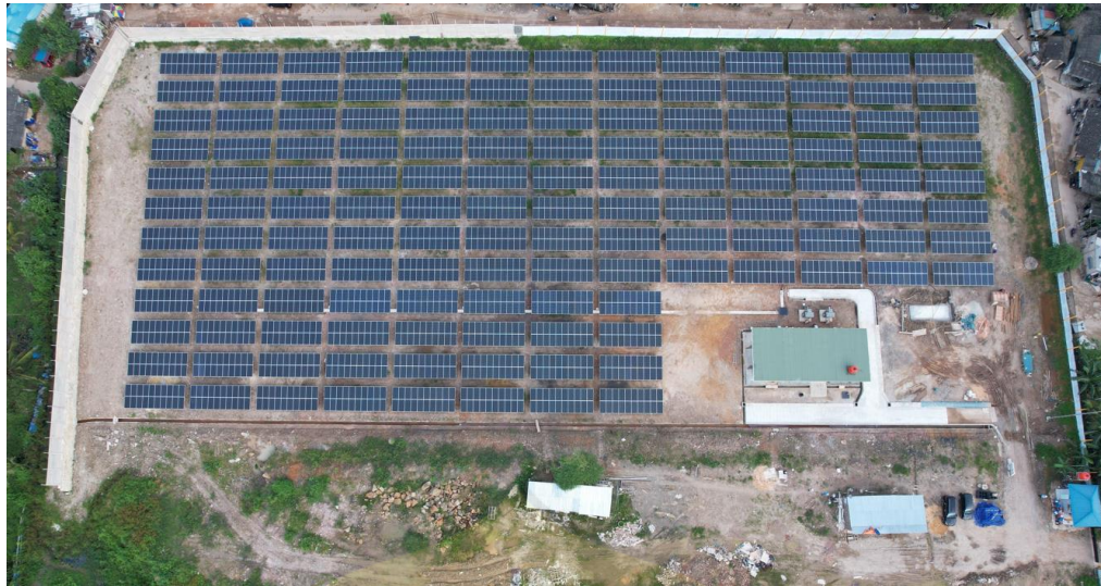
Gambar PLTS 1MWp Tanjung Uma – Batam
