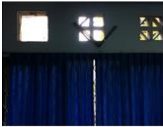
Terdapat ventilasi di ruangan AC
