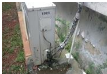
Pipa tidak dilapisi isolasi
