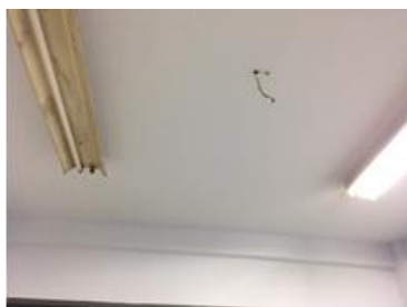
Lampu rusak dibiarkan
