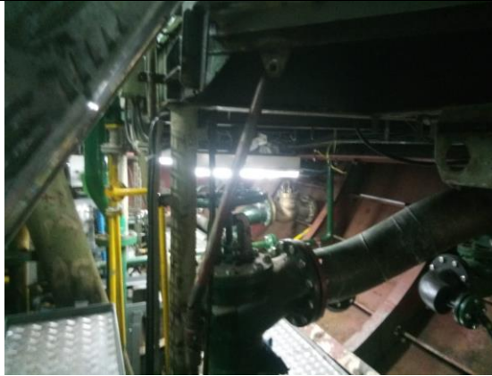
Gambar 2. Ruang Mesin Utama
