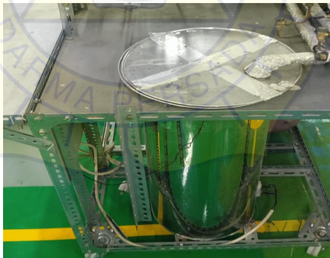
Gambar 2. 3 evaporator Sumber: dokumen pribadi
