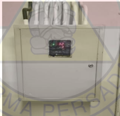
Gambar 2. 5 Indikator temperatur trafo
