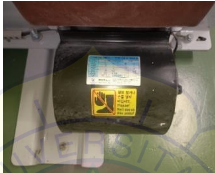
Gambar 2. 6 Cooling fan trafo
