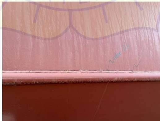
Gambar 20. Undercut pada joint sideshell to chine Sumber : Dokumentasi milik pribadi
