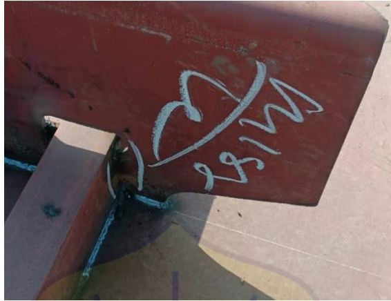
Gambar 16. Miss Weld pada Web to angle bar Sumber : Dokumentasi milik pribadi
