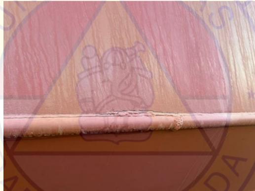
Gambar 19. Poor welding pada joint sideshell to chine Sumber : Dokumentasi milik pribadi
