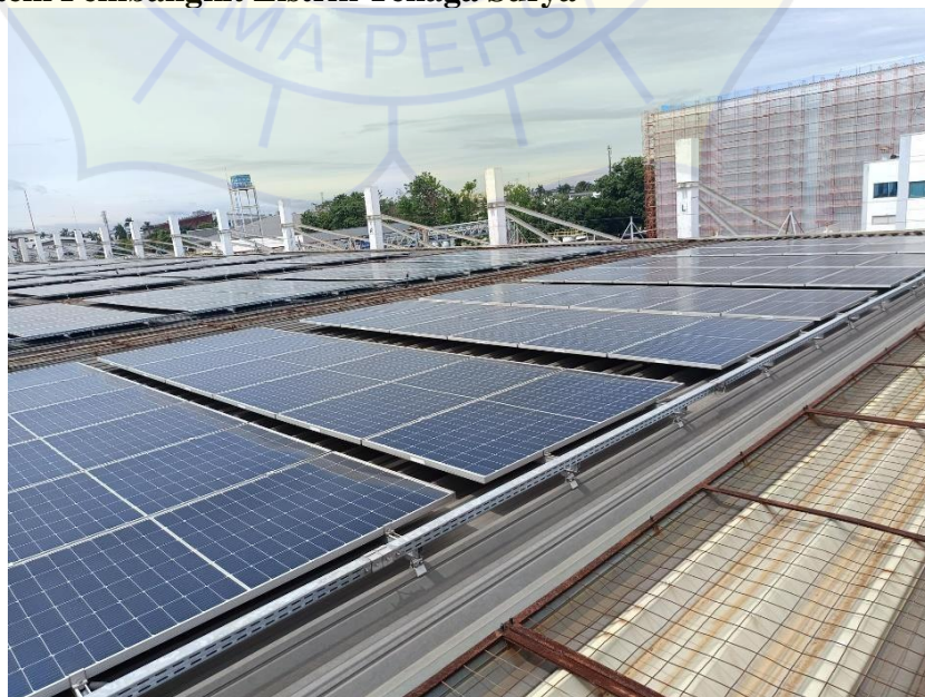
Gambar 2.4 PLTS Rooftop di Kawasan Industri (Cikarang Listrindo, 2024)
