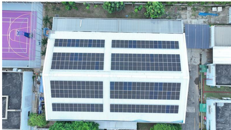
Gambar 2.16 Tampak Atas PLTS Atap On-grid di Kawasan Industri (Cikarang Listrindo, 2024)
